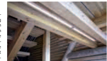
Die LED-Beleuchtung integriert sich nahtlos in die Holzkonstruktion des Biomasse-Heizwerkes.
