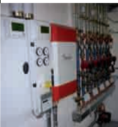
Das installierende Elektrounternehmen Engljähringer fand einen Weg, die BACNet basierende Regelung des Heizwerkes und den KNX auf Automatisierungsebene zusammenzuführen.
